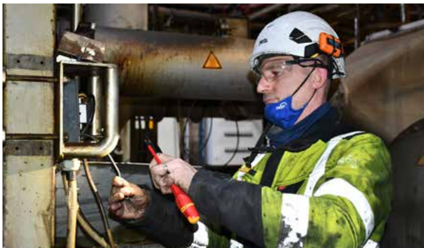
Renewi laisse autant que possible ses techniciens réaliser les adaptations électriques et résoudre les défaillances. (Photo VC)
